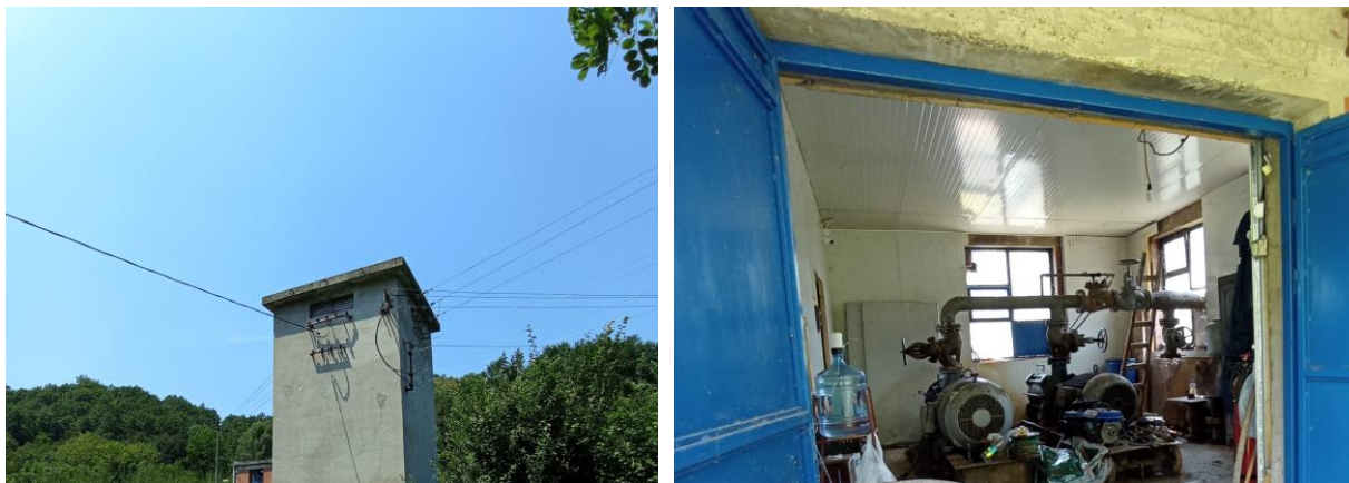
Slika 35. Postojeća trafostanica i pumpna stanica ( unutrašnjost)
